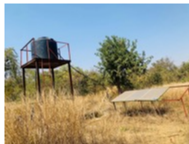
Réservoir d'eau de 1000 litres et 3 panneaux scolaires avec supports métalliques
