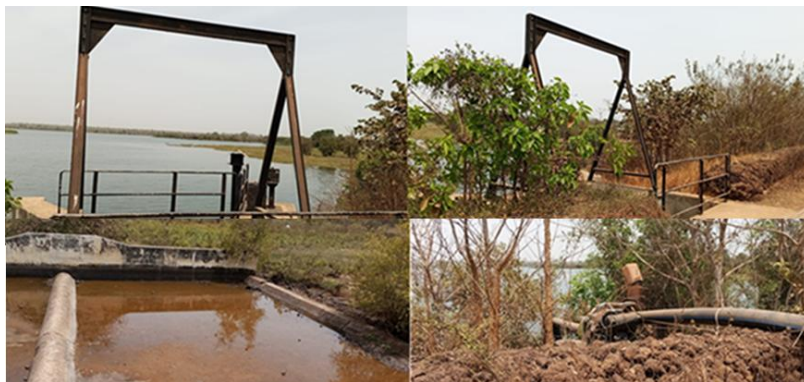
Figure 25 : Barrage de régulation hydraulique de l'Anambé situé à la Kayanga et dispositif de pompage de l'eau.
